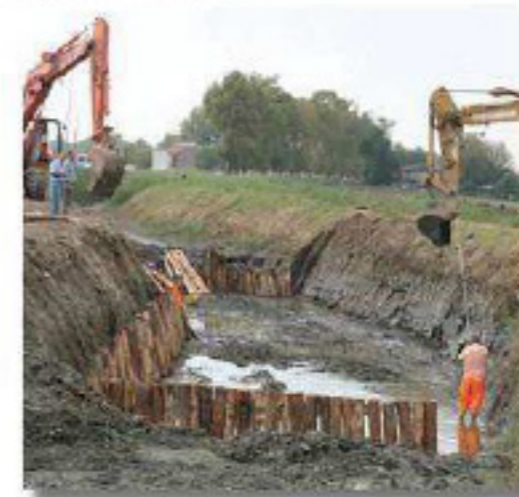
Trappola per sedimenti Canale di San Giovanni (Consorzio di bonifica pianura di Ferrara, 2008 - Comune di San Giovanni in Persiceto - Provincia di Bologna)
