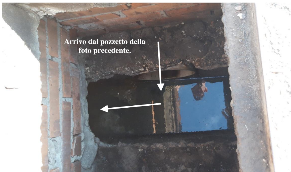
Pozzetto lungo la via Botti dove arriva il collegamento con il pozzetto della foto precedente.
