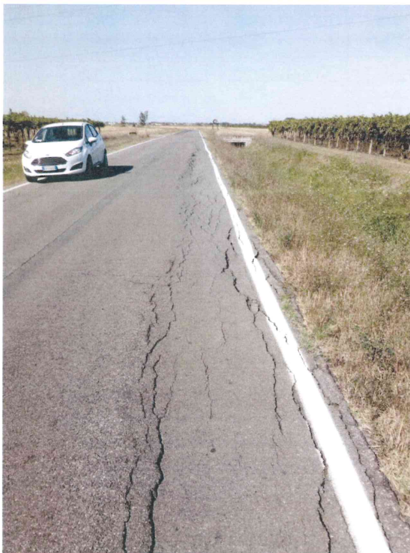
Avvallamento lato est sede stradale
