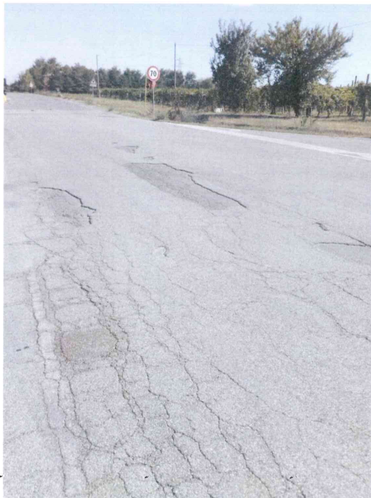
Manto stradale ammalorato in più punti della strada
