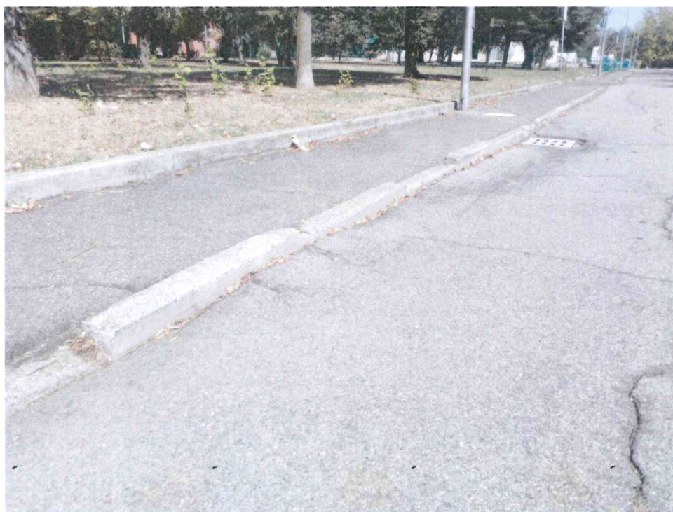
Particolare cordolo da sostituire
