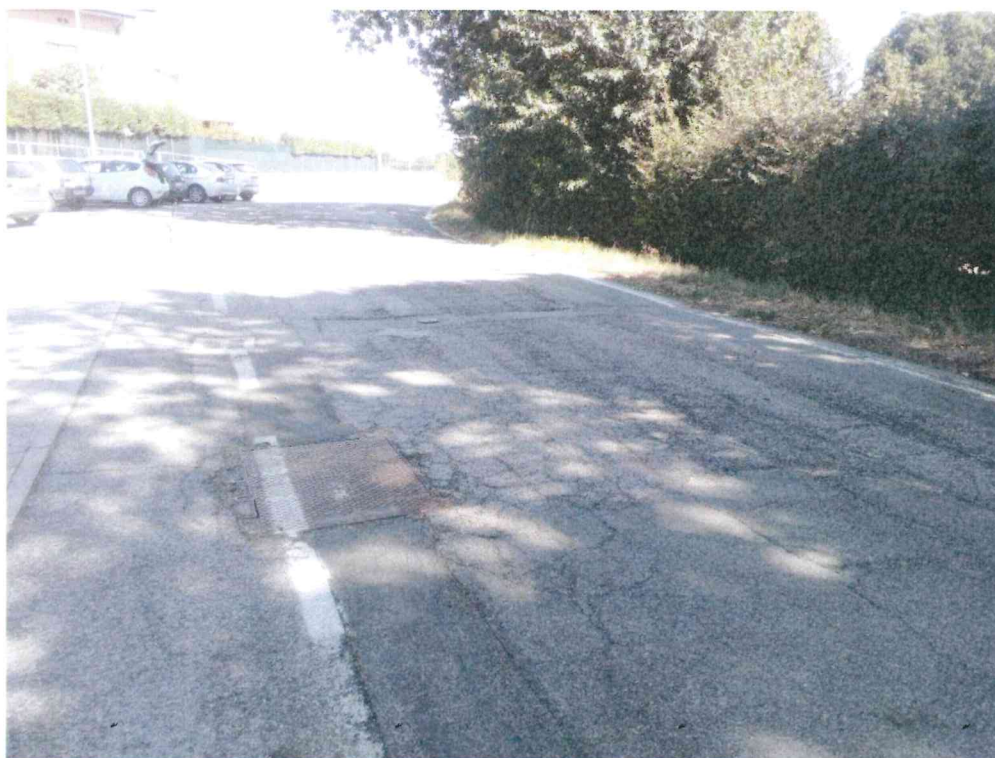
Manto stradale ammalorato in più punti della strada
